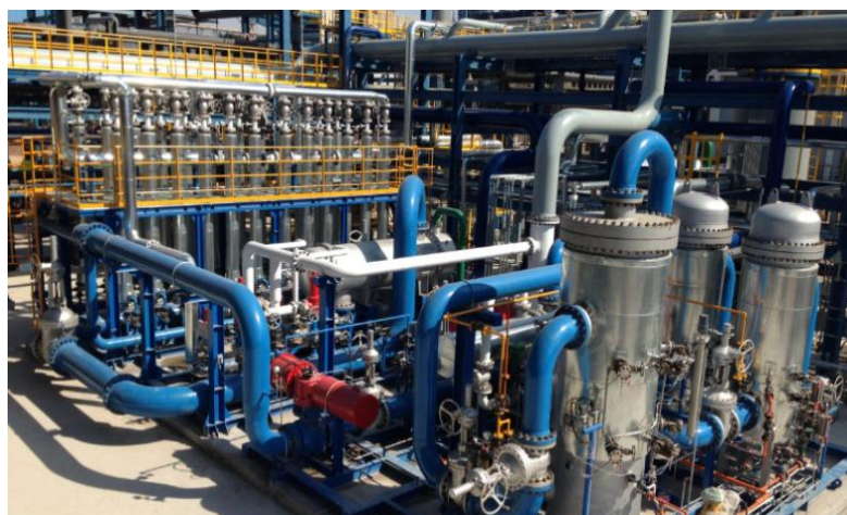
图 1 多源含烃石化尾气梯级耦合分离工艺示范装置
